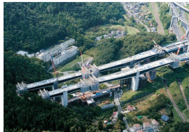
須田氏が現場監督を行った片持ち架設工法による張り出し長が国内最長の裏高尾橋の工事の様子
