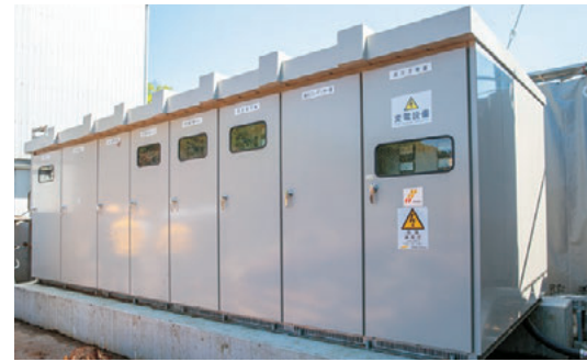
電圧を変換するキュービクル式高圧受電設備
