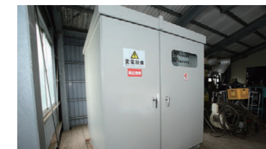
PC138US-10の改造を経て、2022年、有線式電動油圧ショベルPC138USE-11を導入した際、設置されたキュービクル式高圧受電設備
