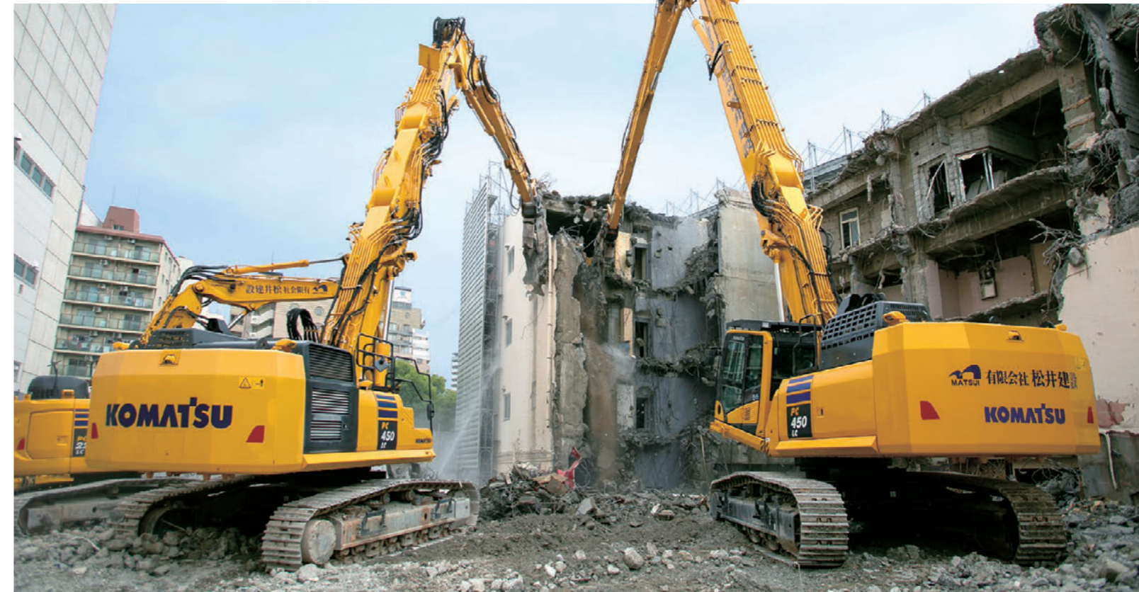
2台の建機が絶妙なコンビネーションで解体業務を進めていく
