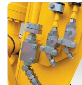
ドレーン付き配管
