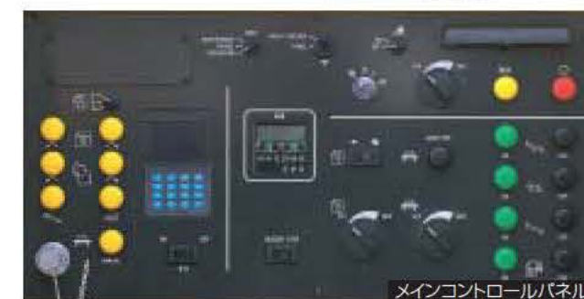
メインコントロールパネル
